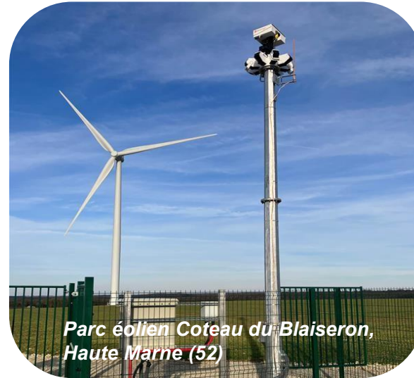
Système de Détection Arrêt de l'avifaune (SDA)
