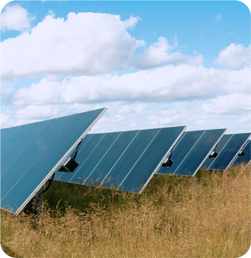
Parc solaire La clé des Champs Saint-Christophe-sur-Dolaizon (Haute-Loire, 43)
